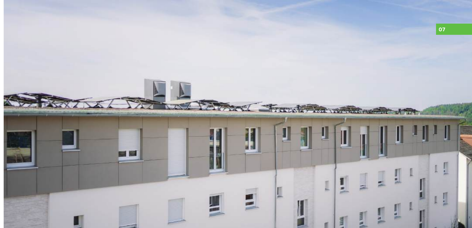
Sichtbares Zeichen der BSV-Klimastrategie: Die Technik auf dem Dach – Wärmepumpe und Photovoltaikanlage – steht für den konsequenten Umbau des Gebäudebestands hin zu erneuerbaren Energien und reduziertem CO 2 -Ausstoß.
